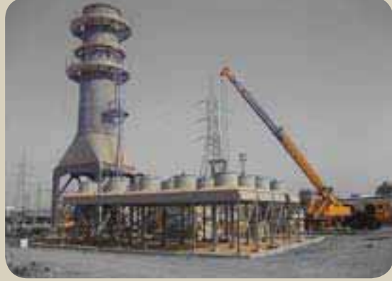
محطة كهرباء التاجي
