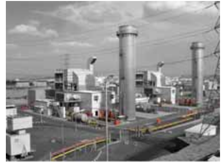
محطة كهرباء التاجي
